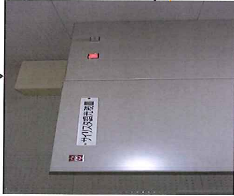
調光制御盤(既設)
