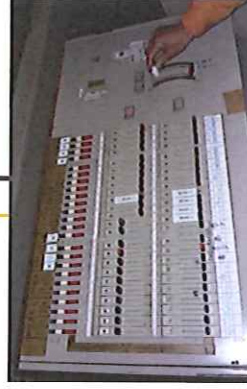
調光操作卓(既設)
