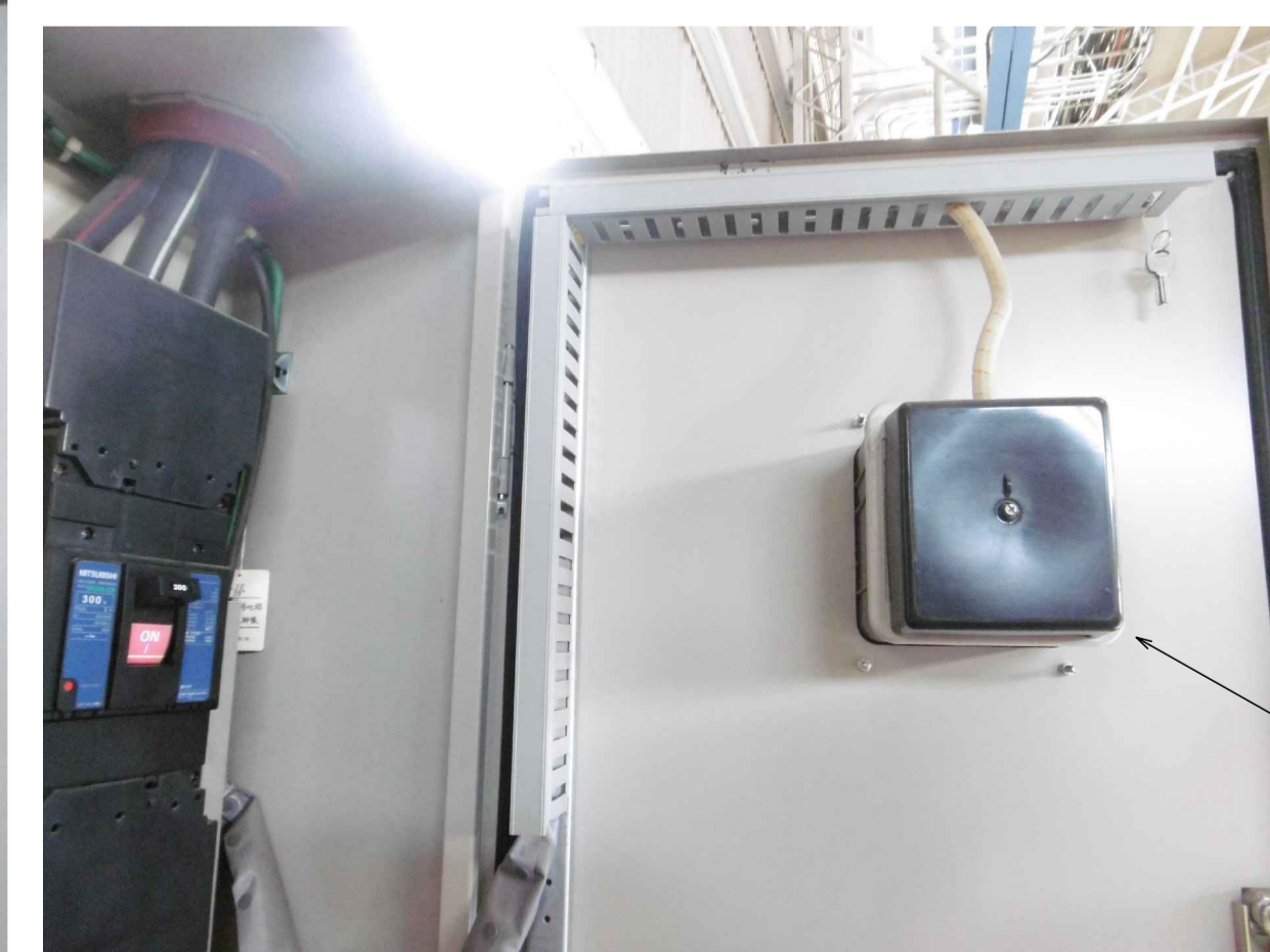
扉面の既設電力量計を撤去し、銅板製プレートを設置する
