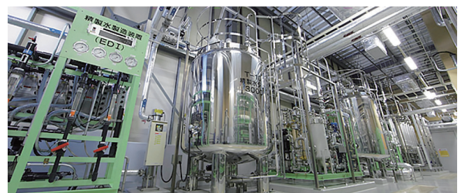
注射用水設備プラント
