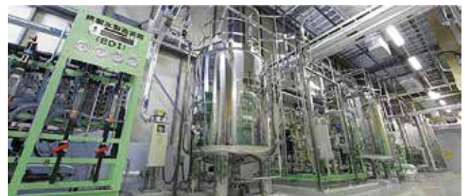
注射用水設備プラント
