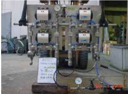
円形高圧ドレス配管
