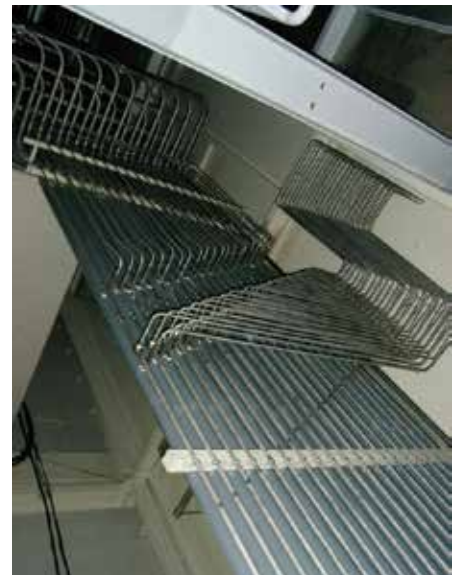
塗料循環配管
