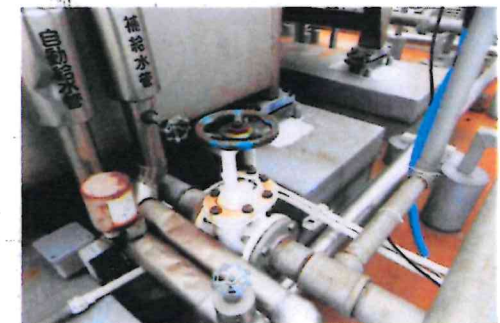
NO.2 冷却塔ドレーンバルブ
