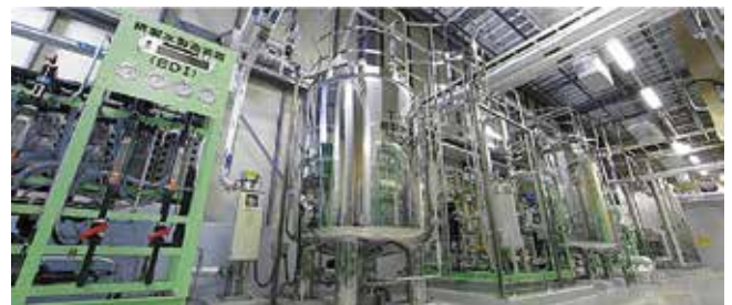
注射用水設備プラント
