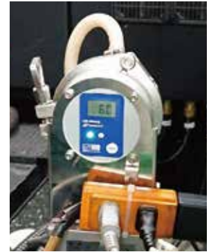
設備に濃度モニターを取り付けた様子
